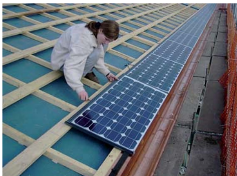
Immeuble locatif, Lausanne / © Edison Power AG, Mönchaldorf
